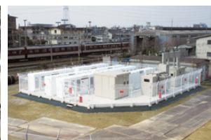
大規模蓄電池
