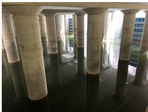
霞ヶ浦導水工事事務所内の那珂機場
